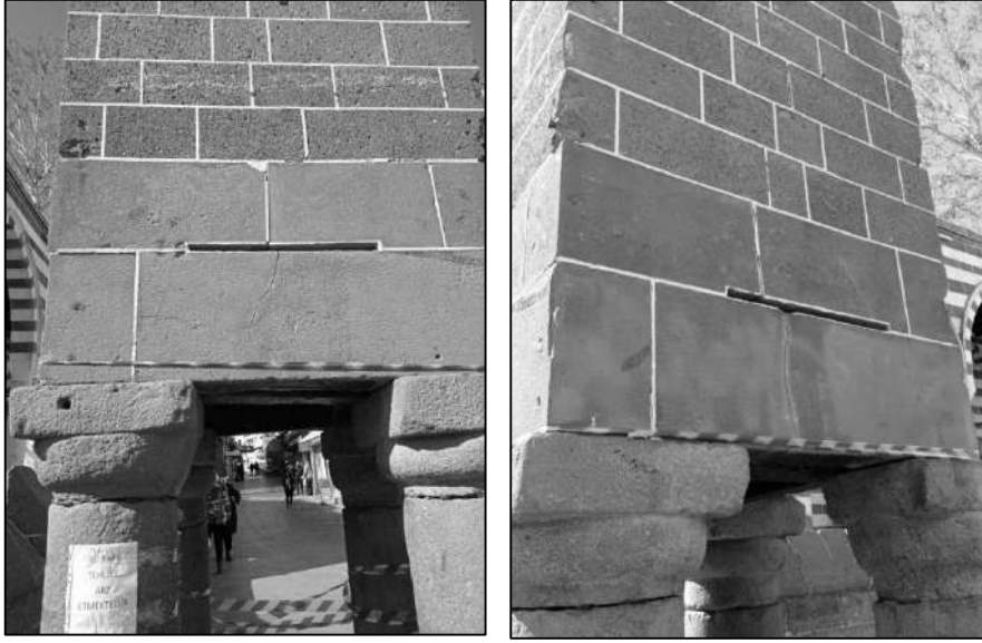
Şekil 8. Dört Ayaklı Minare lentolarındaki çatlak hasarları
