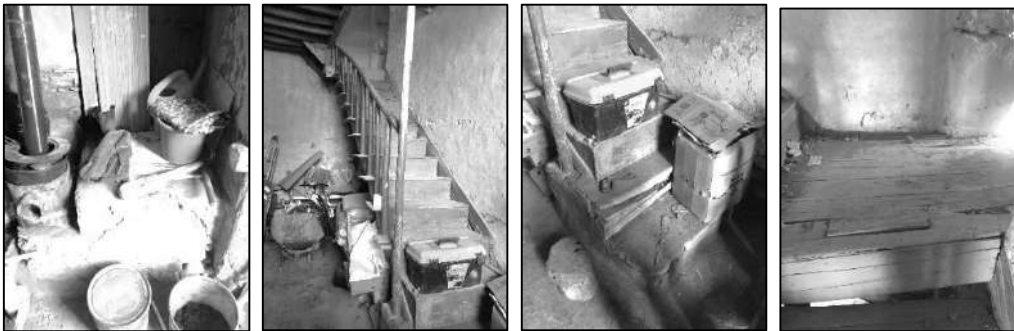
Şekil 18. Eyvan bölümü merdiveninde meydana gelen hasarlar
