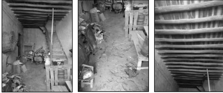
Şekil 16. Eyvan bölümündeki döşeme hasarları
