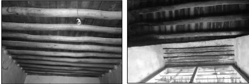
Şekil 20. Kış odası bölümü ahşap tavan kiriş ve lentolarındaki hasarlar
