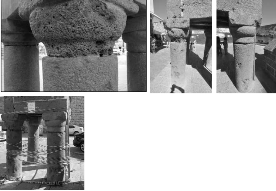
Şekil 7. Dört Ayaklı Minare sütun başlarındaki malzeme kaybı ve aks kayma hasarları (2023)
