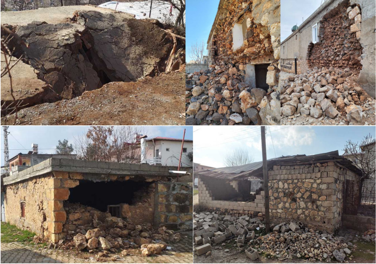
Şekil 8. Yığma yapılarda oluşan hasar örnekleri
