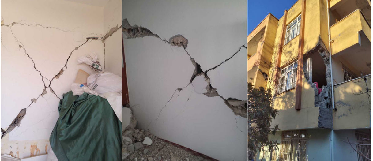
Şekil 7. Dolgu duvar ve ağır çıkma hasarları
