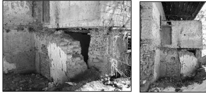
Şekil 13. Kuzeydoğu cephesinde yer alan duvarlardaki hasarlar
