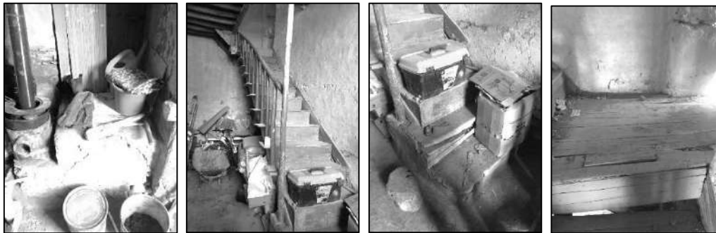
Şekil 18. Eyvan bölümü merdiveninde meydana gelen hasarlar
