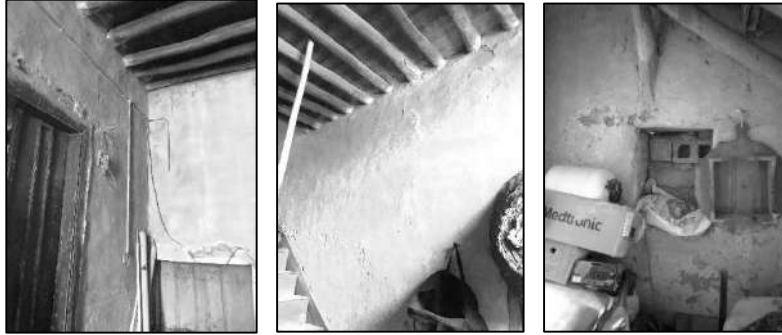
Şekil 17. Eyvan bölümü duvarlarındaki hasarlar
