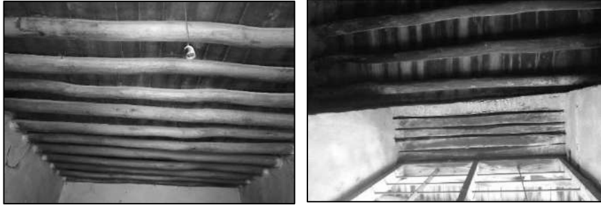
Şekil 20. Kış odası bölümü ahşap tavan kiriş ve lentolarındaki hasarlar
