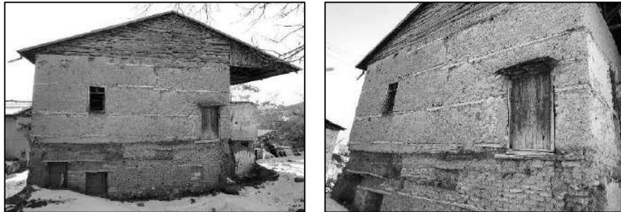
Şekil 12. Kuzeydoğu cephesinde yer alan ahşap elemanlardaki hasarlar
