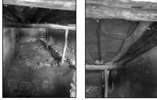
Şekil 23. Bodrum katında meydana gelen hasarlar
