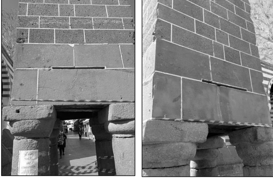
Şekil 8.Dört Ayaklı Minare lentolarındaki çatlak hasarları
