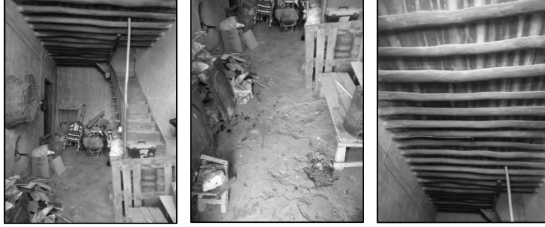
Şekil 16. Eyvan bölümündeki döşeme hasarları
