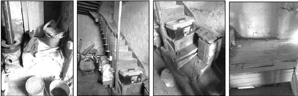
Şekil 18. Eyvan bölümü merdiveninde meydana gelen hasarlar
