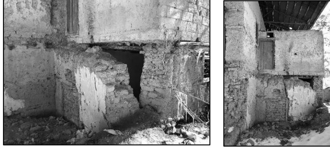
Şekil 13. Kuzeydoğu cephesinde yer alan duvarlardaki hasarlar
