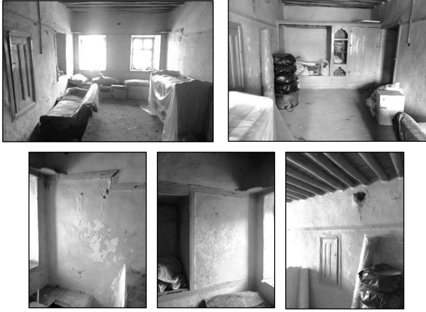
Şekil 19. Kış odası bölümü duvar ve döşemelerinde meydana gelen hasarlar
