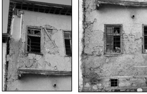
Şekil 7. Güneydoğu cephe duvarındaki yapısal hasarlar
