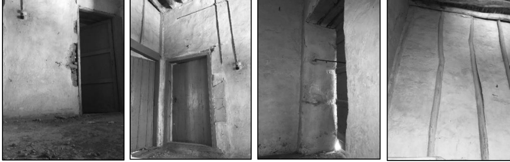
Şekil 22. Birinci kat duvarlarında meydana gelen hasarlar
