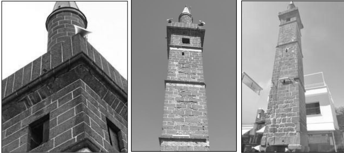
Şekil 11. Minare şerefe ve petek bölümünde meydana gelen malzeme kaybı hasarları (2023)
