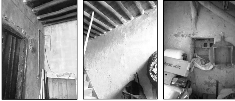
Şekil 17. Eyvan bölümü duvarlarındaki hasarlar
