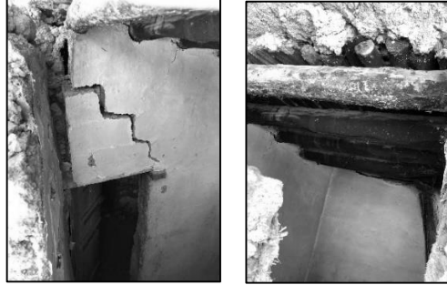
Şekil 14. Zemin kat hela bölümündeki duvar ve üst döşeme hasarları
