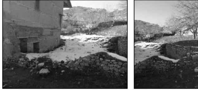
Şekil 11. Zemin katında yer alan merak ve ağıl duvarlarındaki hasarlar
