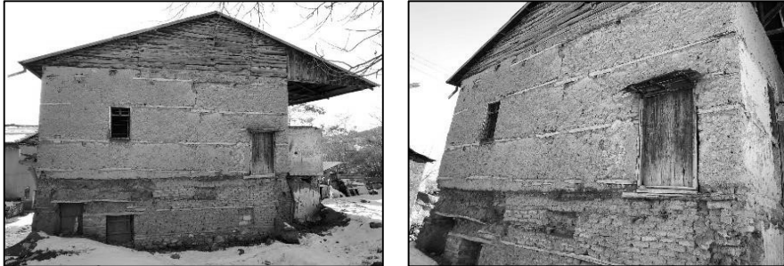
Şekil 12. Kuzeydoğu cephesinde yer alan ahşap elemanlardaki hasarlar
